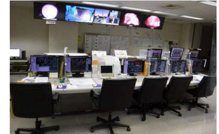
ちゅうおうせいぎょしつ 《中央制御室》
